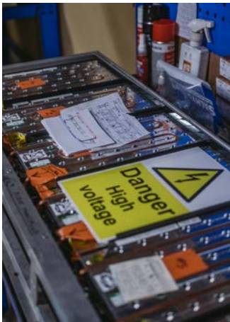
↑ EN DEL AV BATTERIMODULEN.
